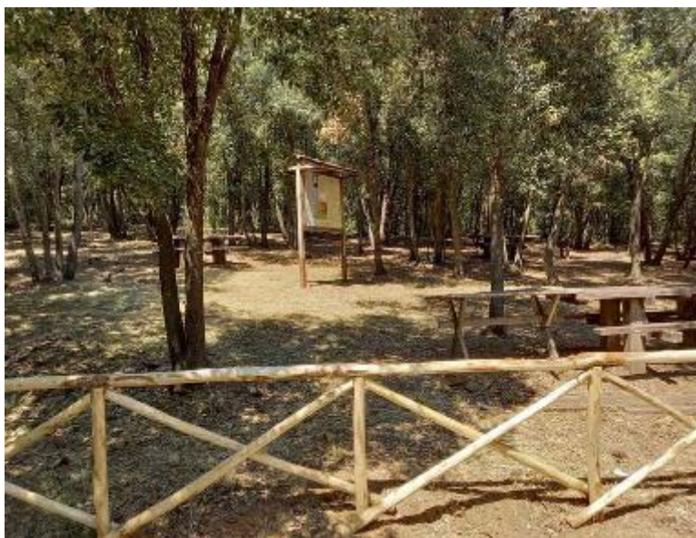
Una delle aree picnic che sono state oggetto dei lavori di riqualificazione
